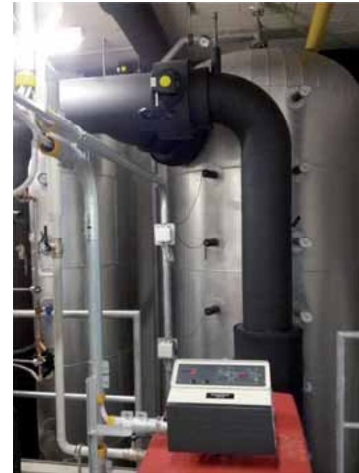
Kaltwasserspeicher 2 x 13 000 Liter
